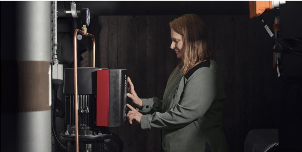
Geoenergianläggningen i Pärnet 6 togs i drift i maj 2025 och förser nu hela fastigheten med både värme och kyla. Humlegården har höga förväntningar på satsningen, vilken förväntas innebära en minskning av fastighetens energiförbrukning med cirka 75 procent.
